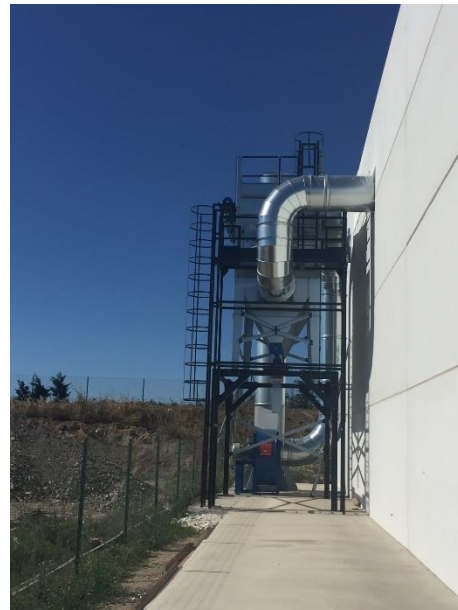
☞ Photographie 12 : Centrale de dépoussiérage
